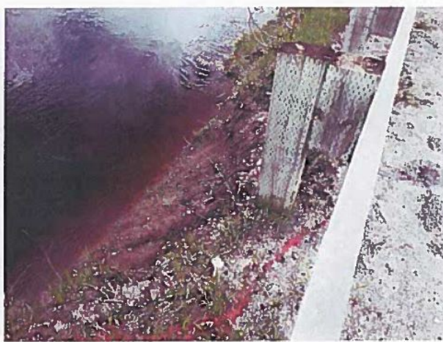
FIGURE 2. GLISSEMENT DE TERRAIN SUPERFICIEL AVEC DÉCROCHEMENT – SECTEUR 4
