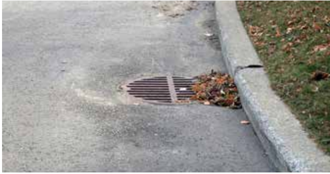
Figure 7.16 Accumulation de débris au point bas.
