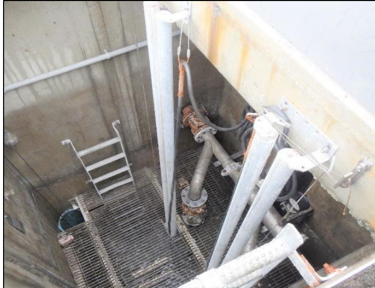
Figure 6-16. Poste de pompage avec un palier en grillage (caillebotis) et des accessoires limitant l'installation d'une sonde ultrasonique ou d'une sonde radar pour suivre le niveau des eaux
