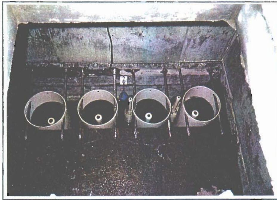
⤴ L'intérieur de la chambre des préfiltres
