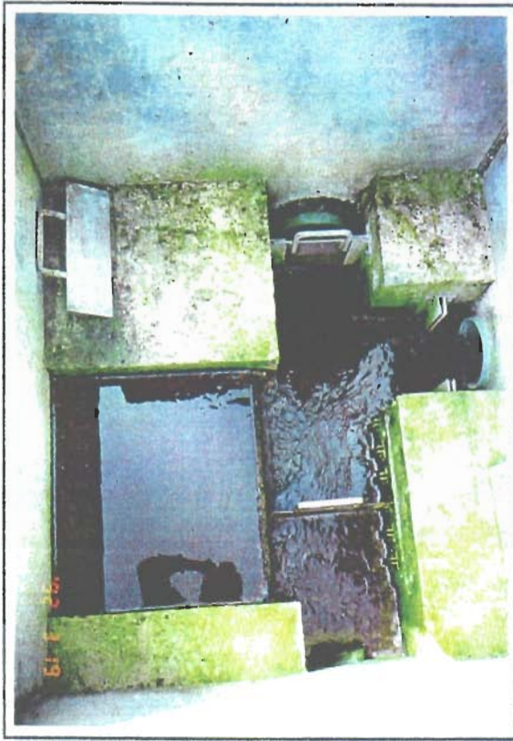
↙ Le regard de répartition de l'eau filtrée
