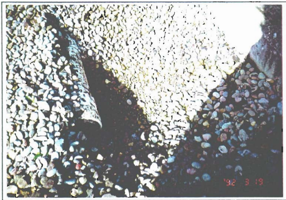
↑ Le milieu filtrant et le gravier de recouvrement
