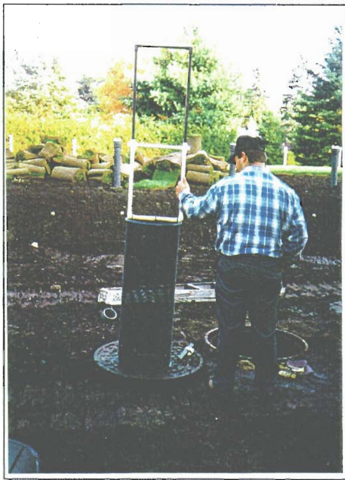
Le tamis du préfiltre prêt à être installé dans le 2 e compartiment de la fosse septique
