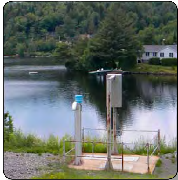
Poste de pompage avec ouvrage de surverse, lac Saint-Denis, Saint-Adolphe-d'Howard
